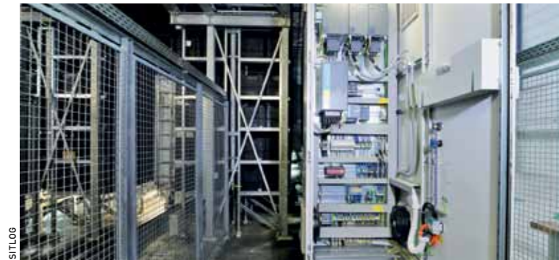
Mitfahrender Schaltschrank mit Siemens „Sinamics S120“ Regelungstechnik
