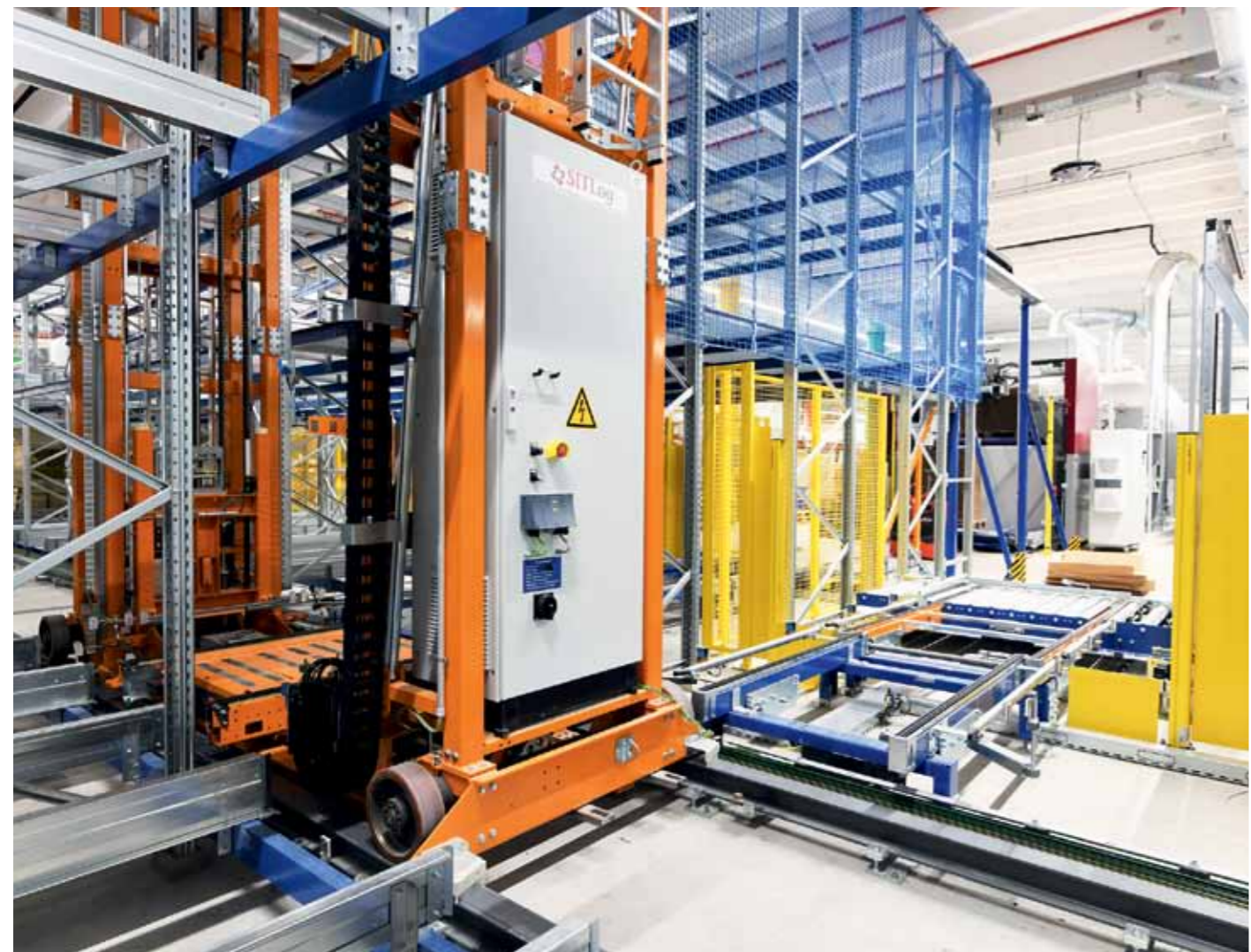
Satellitenlager im EG zur Versorgung der Produktionsmaschinen mit Kartonagen
