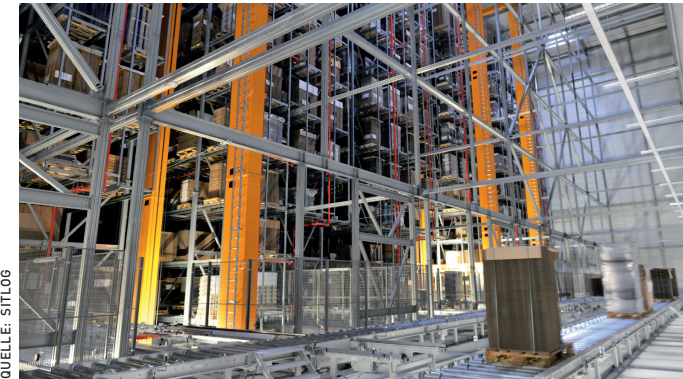
Das Hochregallager bietet Platz für die Aufnahme von bis zu 27.500 Paletten in sechs Gassen.
