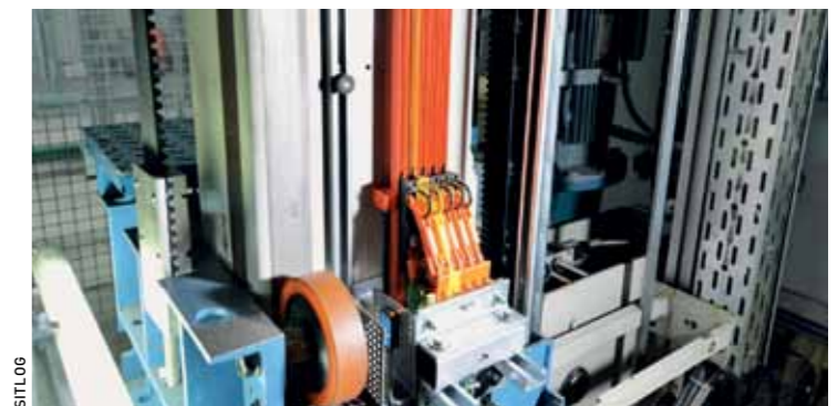
Ergänzende Optimierungsmaßnahme: Die alten Schleppketten der RBGs wurden für eine ungehinderte Stromzuführung durch Schleifleitungen ersetzt. Die Datenübertragung zum Lastaufnahmemittel erfolgt jetzt über Datenlichtschranken.
