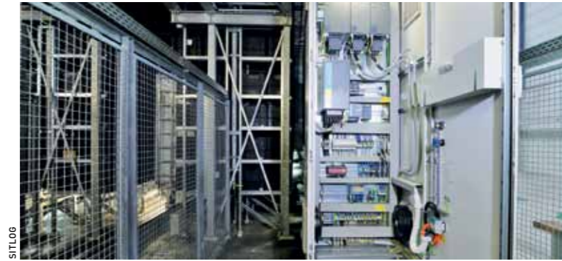
Mitfahrender Schaltschrank mit Siemens „Sinamics S120“ Regelungstechnik
