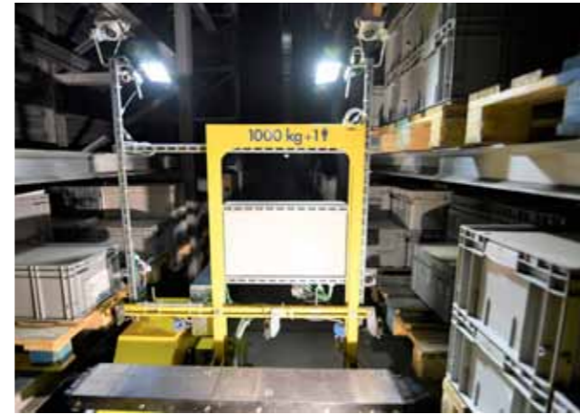
Je RBG sind vier Kameras installiert. Durch sie können Störungen besser lokalisiert und ggf. von unten quitiert werden.
