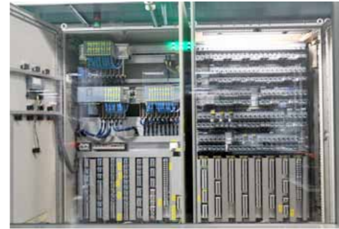
Die vorhandenen S5-Steuerungen wurden durch aktuelle TIA-Steuerungen inklusive direkt angebundener Peripherie abgelöst.
